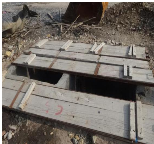
修配站设置的隔油池
